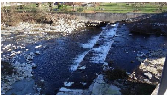
Traversa ad uso energetico, in comune di Pianfei
