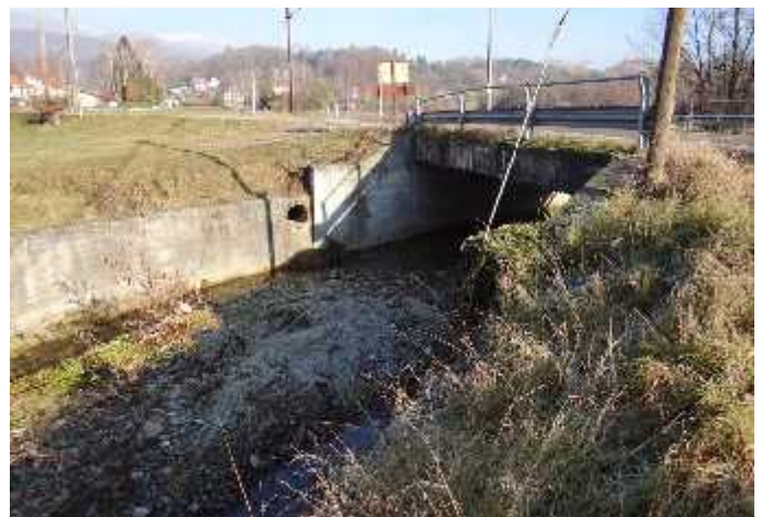
Attraversamento della SP 60 in corrispondenza di un'ansa protetta da muri a difesa delle sponde
