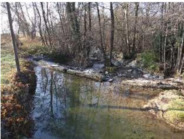
Traversa danneggiata a monte del tratto
