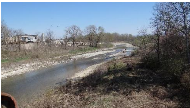
Difese spondali in sinistra nella parte iniziale del tratto.
