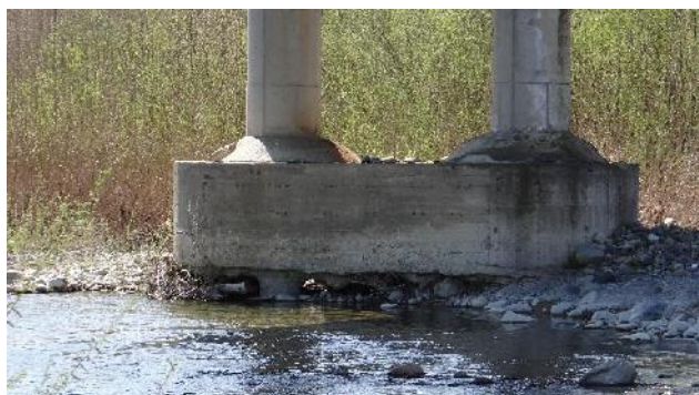
Pila del ponte Garaglia-Francavilla Bisio sottoescavata
