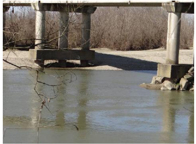
Pile del ponte della SP118 sottoescavate.
