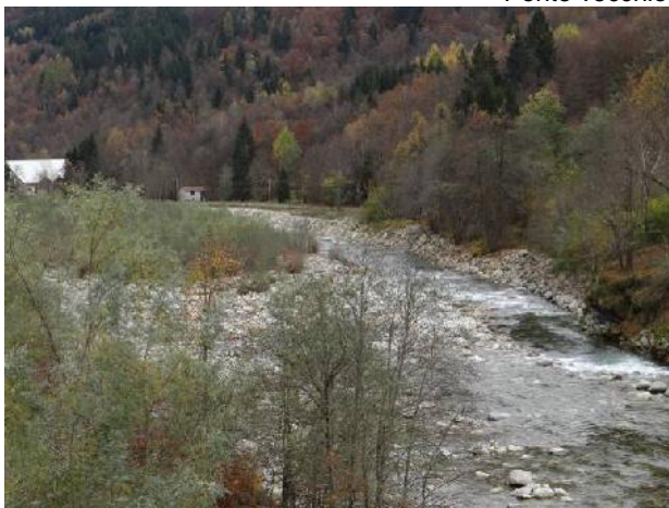
Scogliera in massi cementati a difesa della sponda idrografica destra a valle del ponte di Pila.
