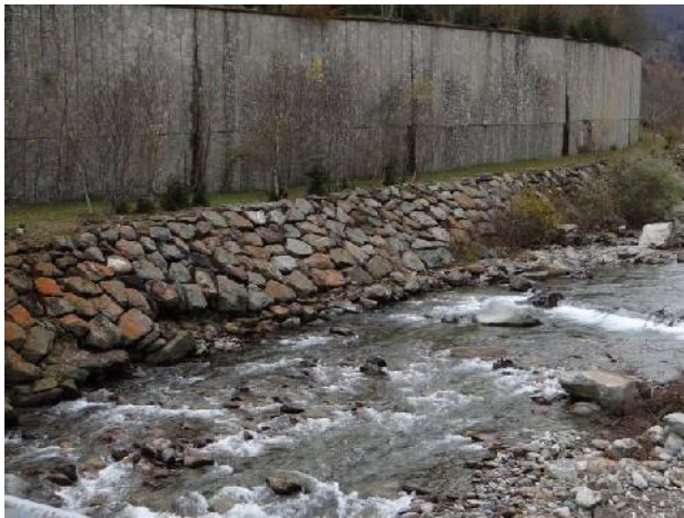
Opere di difesa della sponda idrografica destra sottoescavata in alcuni punti.
