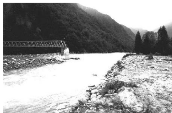
Settembre 1993: la piena del F. Sesia demolì parte del ponte in ferro ed erose la sponda sinistra, asportando le attrezzature sportive comunali. (da "Alluvioni in Valsesia")
