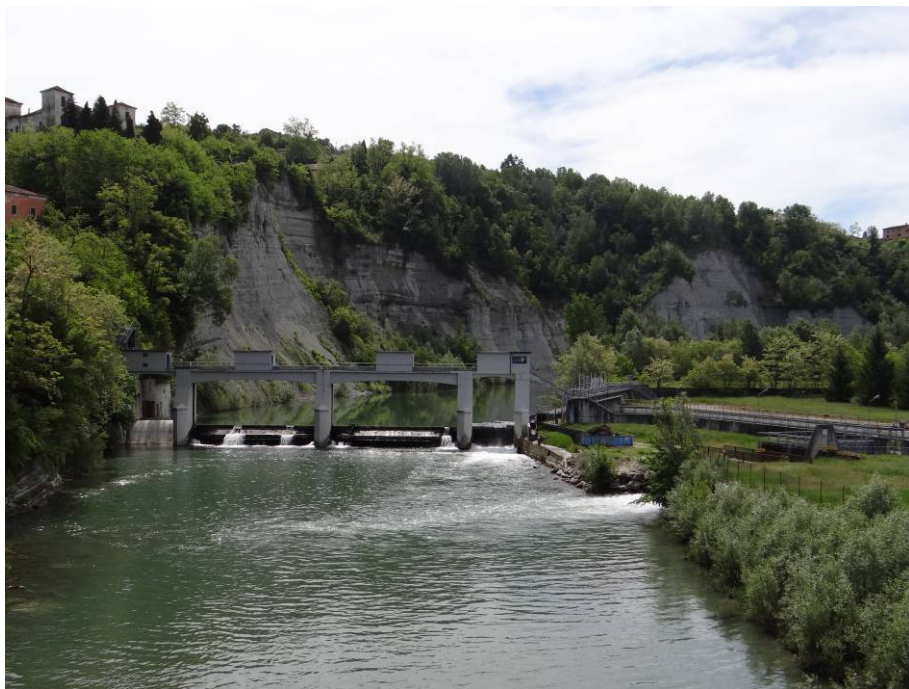
Traversa di derivazione Edison
