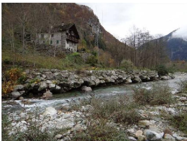
Sottoescavazione della scogliera a protezione delle baite in sponda idrografica sinistra a valle di Maggenghe.
