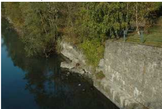
Vista verso monte dal ponte di Quassolo; opere di difesa spondale in sinistra idrografica danneggiate per erosione localizzata.
