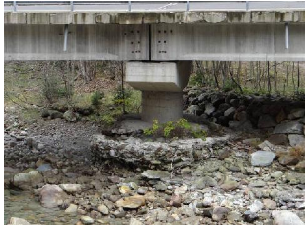
Pila del ponte di Isoello sottoescavata.
