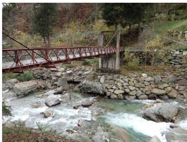
Passerella pedonale a Mollia con difesa spondale sottoescavata.
