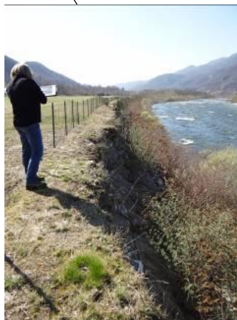
Sponda erosa in corrispondenza dell'avicampo di Roccapietra.
