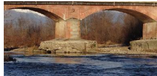
Particolare delle pile del ponte della SP3 sottoescavate
