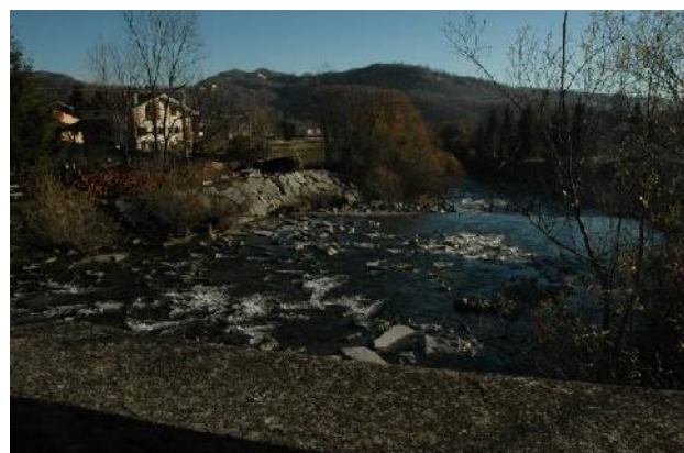
Vista verso valle del T. Savenca dal ponte della strada comunale; scogliera in massi cementati in sinistra.
