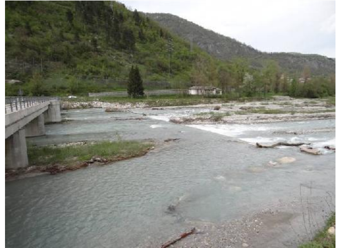
La soglia posta a protezione del ponte a monte dell'abitato di Moiola
