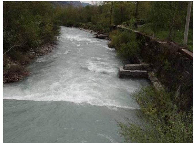
Il tratto in corrispondenza dell'attraversamento per lo stabilimento dell'acqua Sant'Anna: sono visibili le opere presenti
