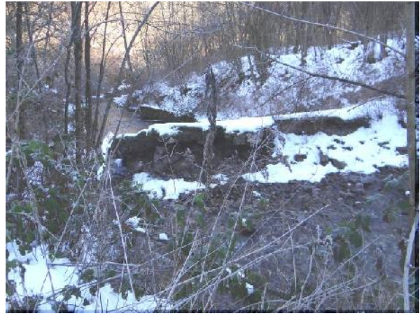
Vista da monte della traversa in disuso. Il "petto" è stato sottoescavato per aggiramento dell'opera .
