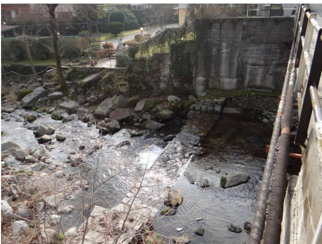
Soglia a protezione dell'opera di attraversamento.
