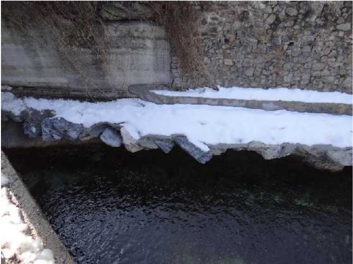
Sottoescavazione difese in sponda destra
