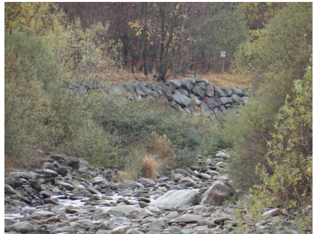
Difese spondali in loc. Novareglia.
