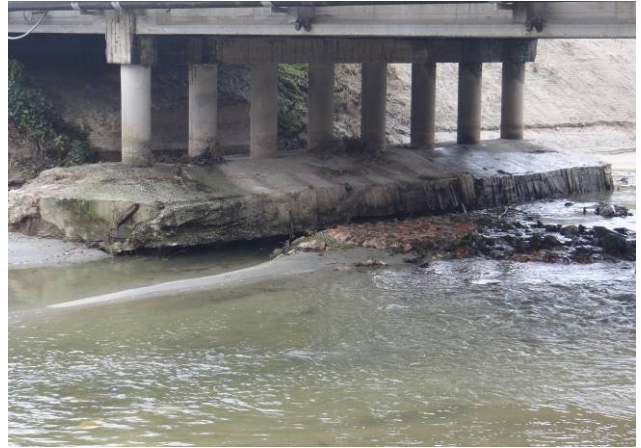
Vinovo: dettaglio ponte della SP143, pila sottoscavata.
