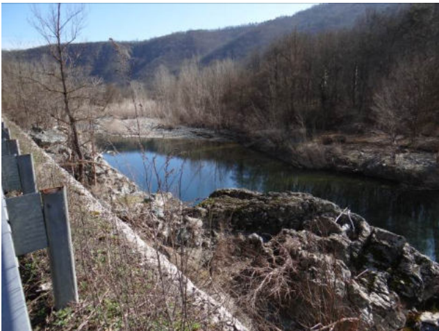
Alveo a monte di Spigno, difesa di sponda a fianco della strada.
