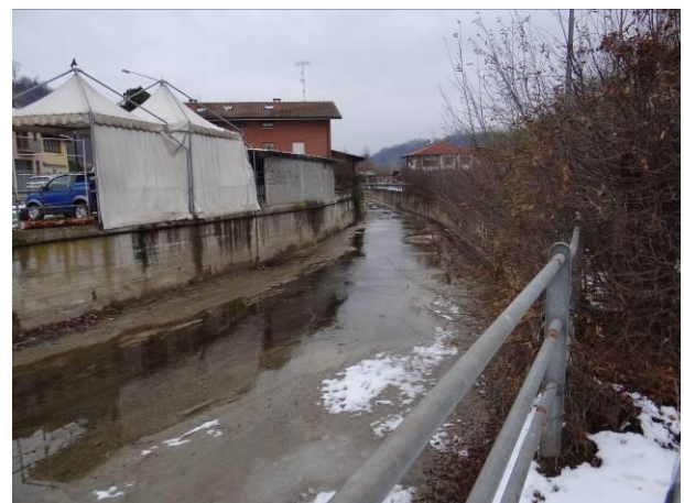
Alveo a Borbore, con fondo rivestito e sponde difese da muri in cemento.
