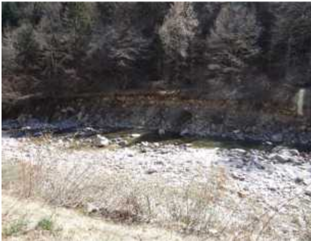
Erosione sponda idrografica destra
