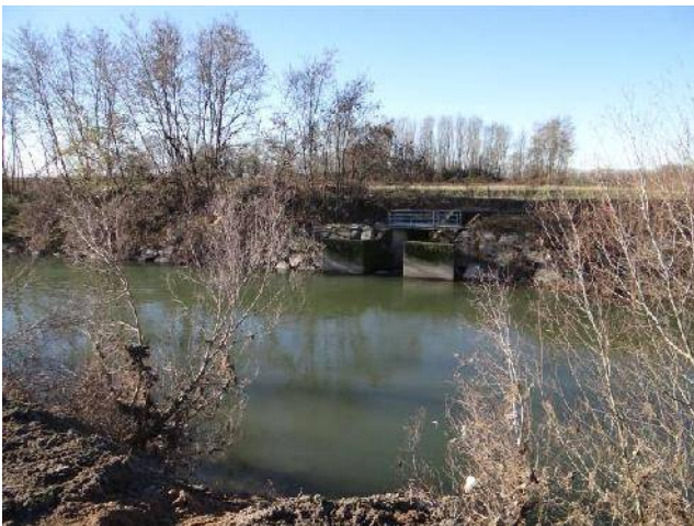
L'uscita dello scaricatore di cavo Panizzina.
