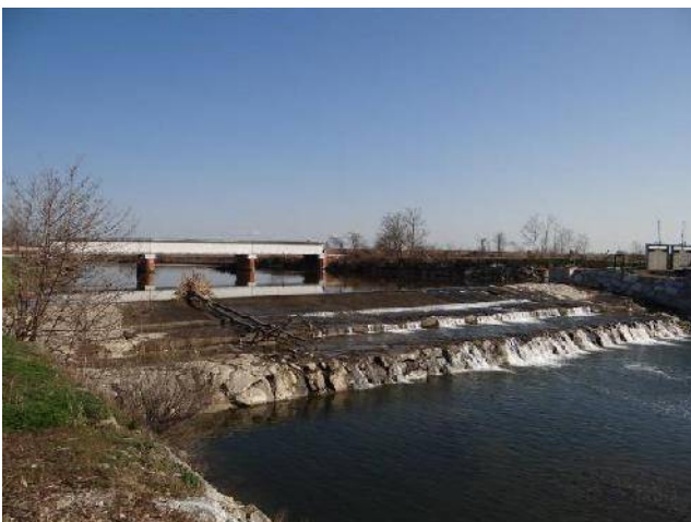
Traversa di derivazione Roggia Mora.
