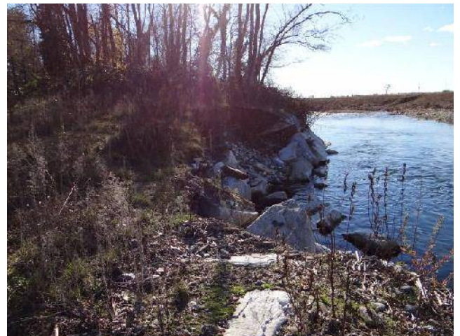
Erosione di difese spondali nella stessa località.
