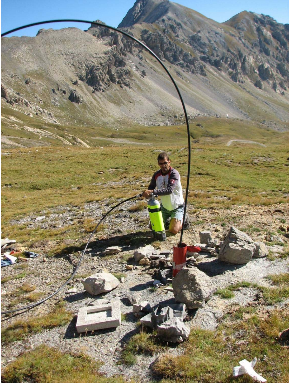
Sito del Passo della Gardetta (Canosio, CN) – Spurgo del pozzo profondo 30 m tramite estrazione dell'acqua con aria compressa (foto: L. Paro, settembre 2011)
