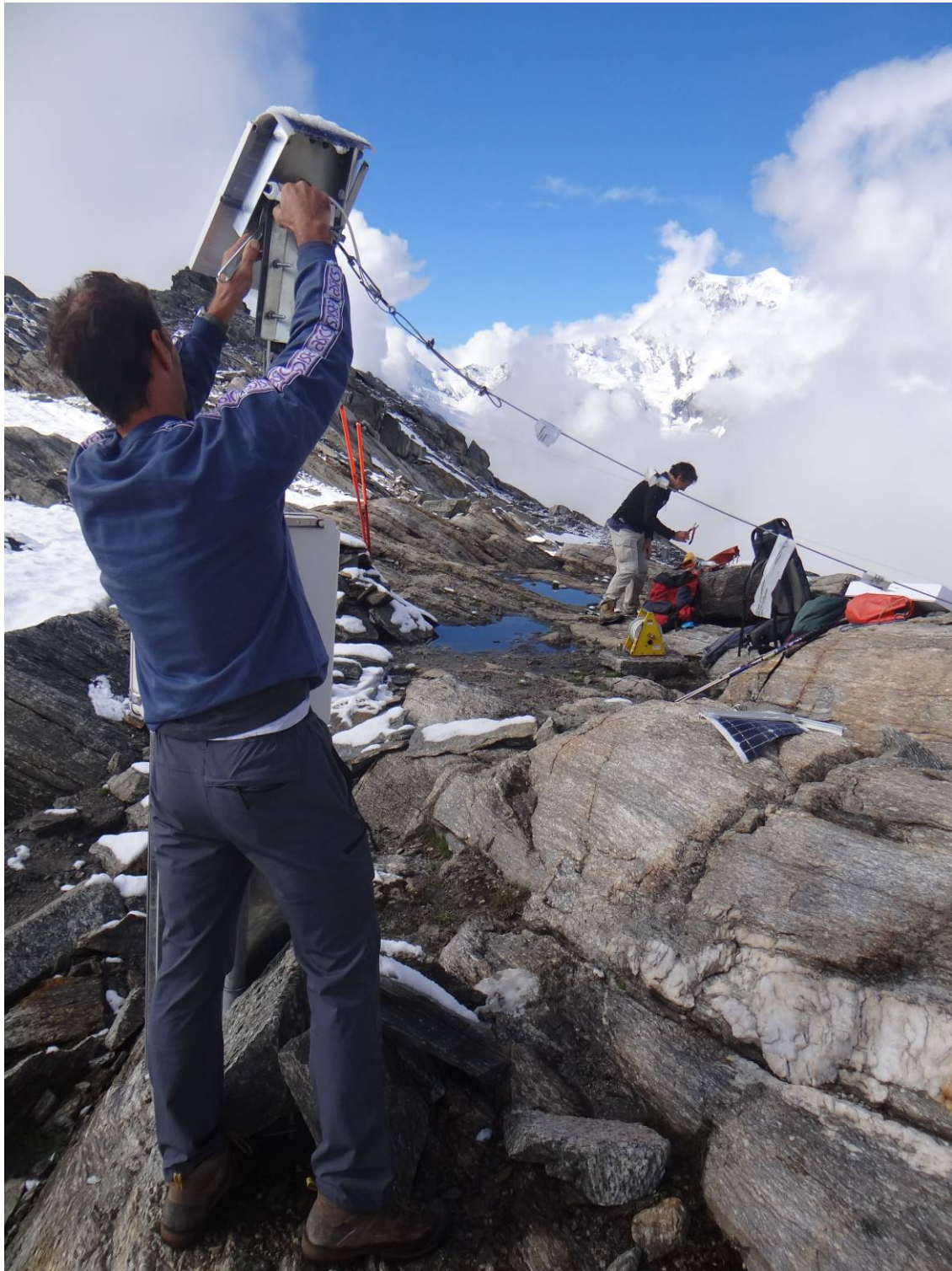
Sito del Passo del Monte Moro (Macugnaga, VB) – Sostituzione del pannello solare danneggiato dal passaggio della macchina operatrice nel corso della primavera 2013 (foto: L. Paro, agosto 2013)
