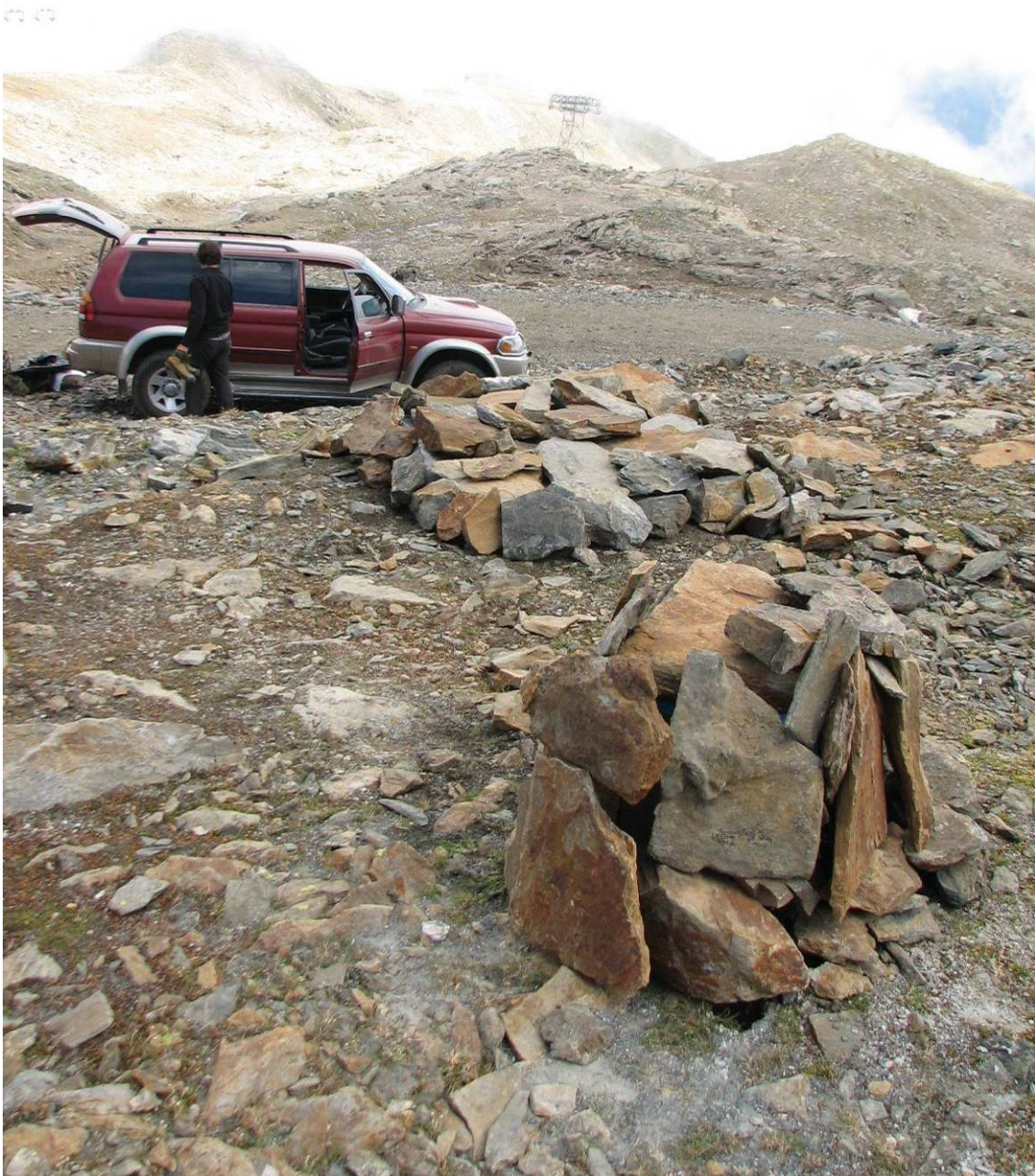
Sito del Passo dei Salati – Istituto Mosso (Alagna Valsesia, VC) – Completamento della stazione e mimetizzazione con pietre locali dell'installazione: in primo piano il tombino del pozzo, in secondo piano il tombino del datalogger e delle batterie (foto: L. Paro, settembre 2011)
