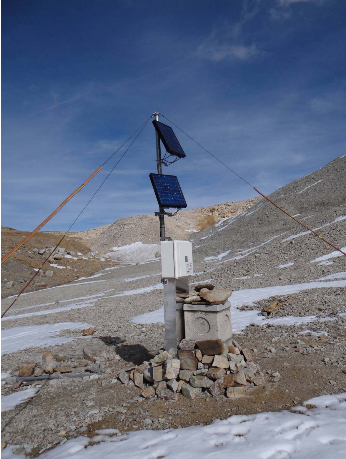
Sito del Colle Sommeiller (Bardonecchia, TO) – Completamento dell'installazione della stazione di monitoraggio dopo gli interventi di sistemazione dell'autunno 2012 (foto: L. Paro, ottobre 2012)
