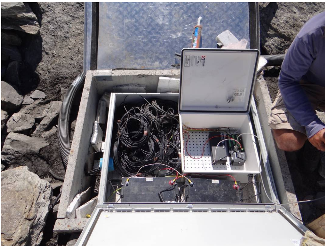
Sito del Passo del Monte Moro (Macugnaga, VB) – Fase di completamento della sopraelevazione della testa-foro del pozzo con messa in posto della protezione metallica e del tombino in cls (in alto) e sistemazione provvisoria del datalogger e delle batterie nel tombino adiacente (foto: L. Paro, luglio 2012)
