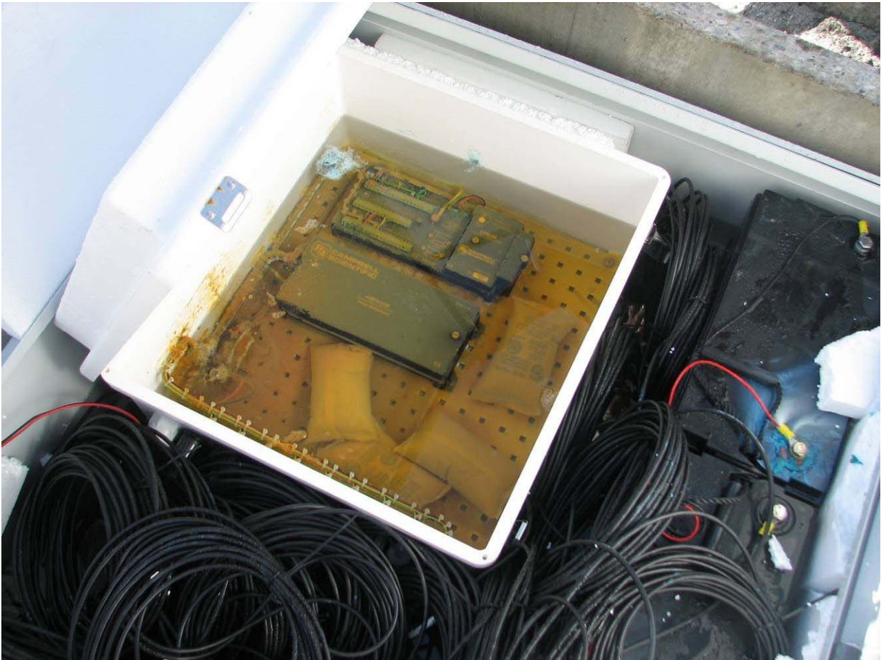
Sito del Passo del Monte Moro (Macugnaga, VB) – Verifica del danno alla strumentazione ed alle batterie a causa delle infiltrazioni di acqua che hanno provocato l'allagamento del tombino (foto: E. Fusetti, agosto 2010)
