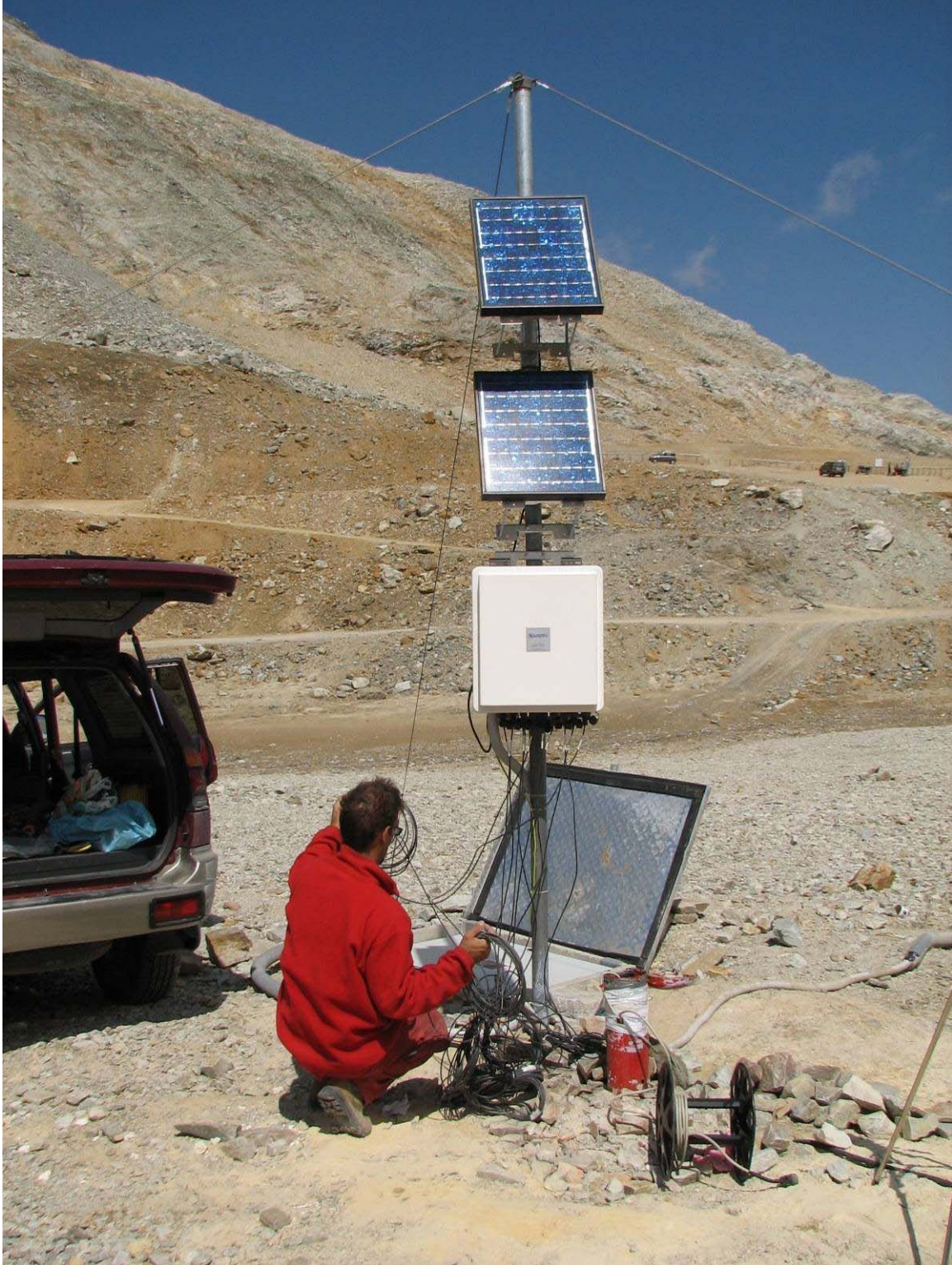
Sito del Colle Sommeiller (Bardonecchia, TO) – Installazione del datalogger e dei pannelli solari di alimentazione sul palo di supporto (foto: L. Paro, agosto 2011)
