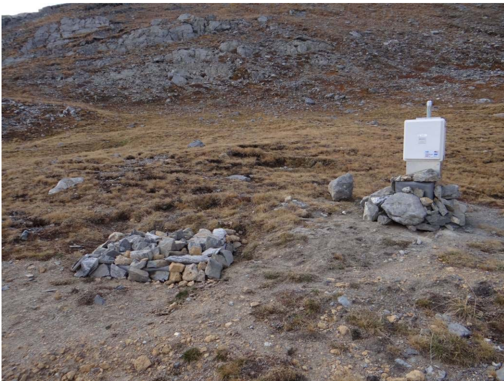
Sito del Passo della Gardetta (Canosio, CN) – Completamento della installazione (in alto) e risultato finale con datalogger su palo verticale e batterie di alimentazione posizionate nel tombino interrato (foto: in alto, G. Moletta, settembre 2012; in basso, L. Paro, ottobre 2012)
