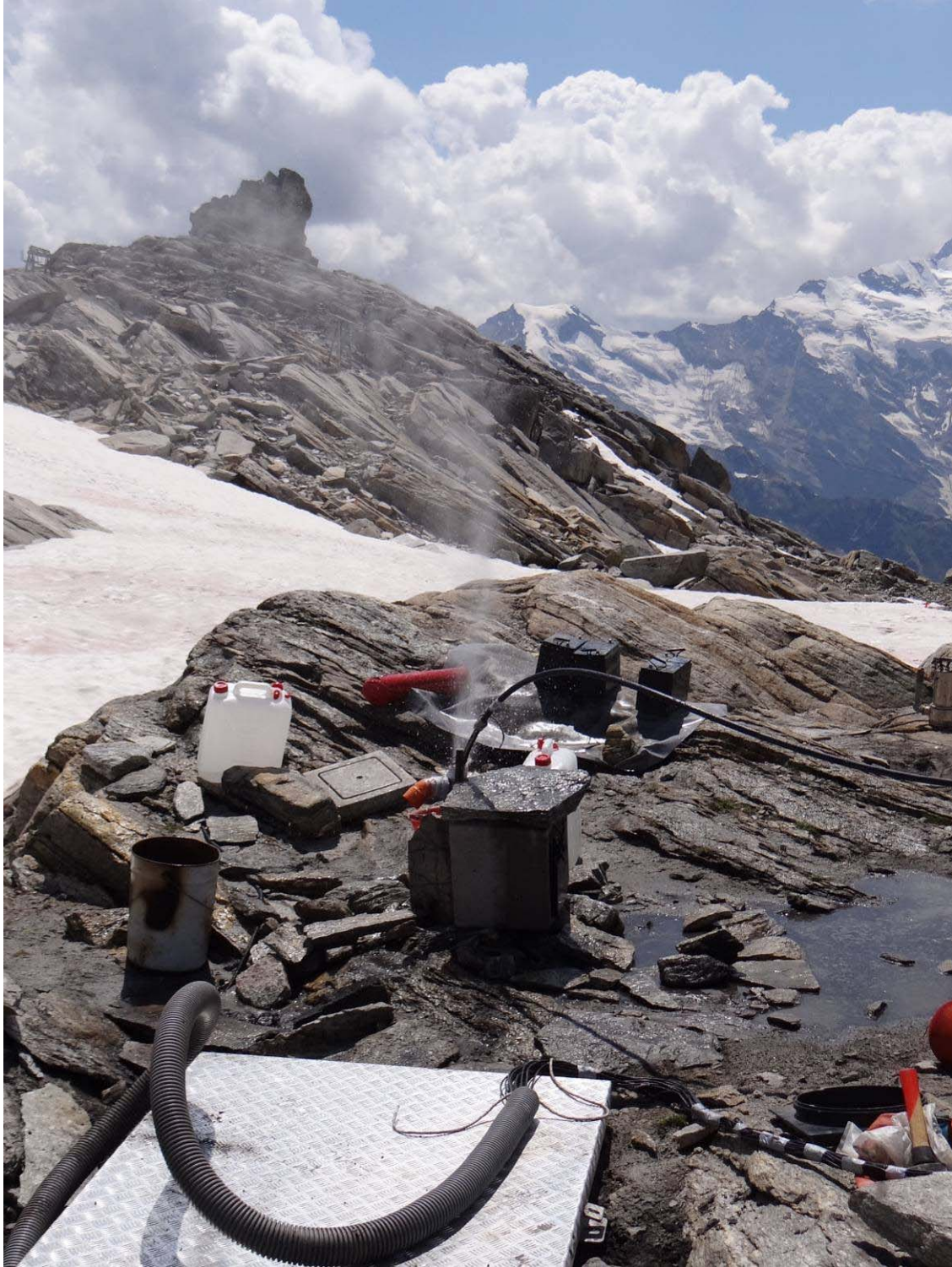
Sito del Passo del Monte Moro (Macugnaga, VB) – Estrazione dell'acqua dal pozzo profondo 30 m tramite l'uso di aria compressa, dopo la fase di scongelamento di circa 20 m di ghiaccio (foto: L. Paro, luglio 2012)
