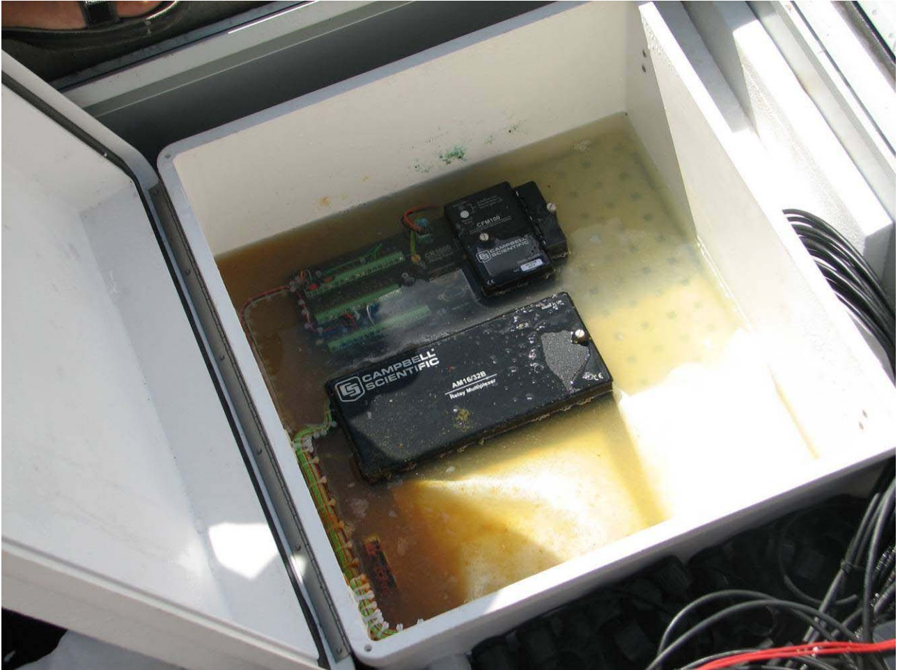
Sito del Passo della Gardetta (Canosio, CN) – Verifica del danno alla strumentazione a causa delle infiltrazioni di acqua (foto: D. Bormioli, agosto 2010)
