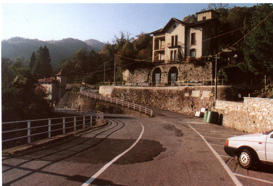
Immagine 02 - Fenomeni di attività della frana
