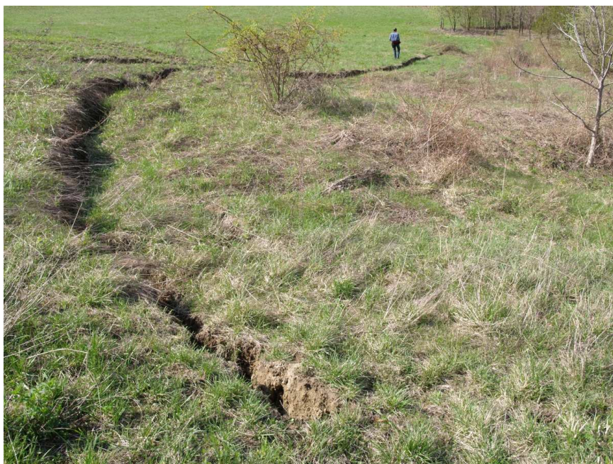
Immagine 17 - 2009_04_06-Una delle numerose fratture formatesi nel mese di marzo 2009 immediatamente a monte del coronamento del fenomeno del 1994
