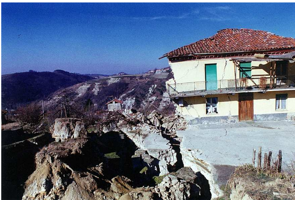
Immagine 11 - Abitazione della borgata Pianezza gravemente lesionata; in secondo piano l'abitazione singola ubicata a valle della frazione
