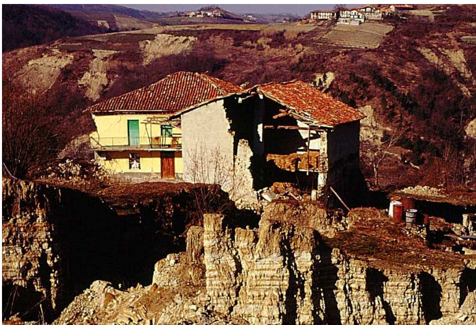
Immagine 10 - Abitazioni della borgata Pianezza gravemente compromesse
