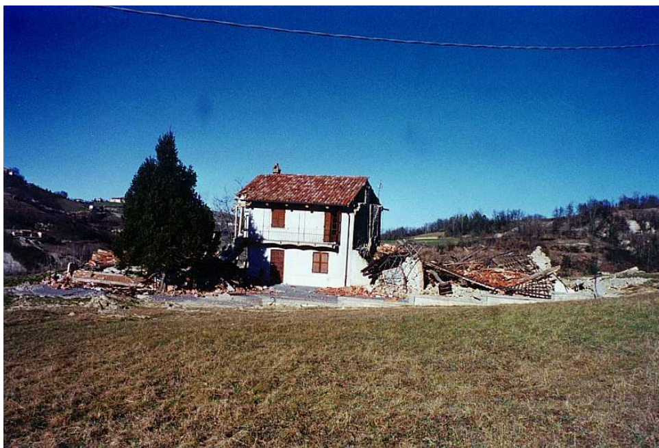
Immagine 13 - Abitazione isolata ubicata a valle della borgata Pianezza gravemente danneggiata
