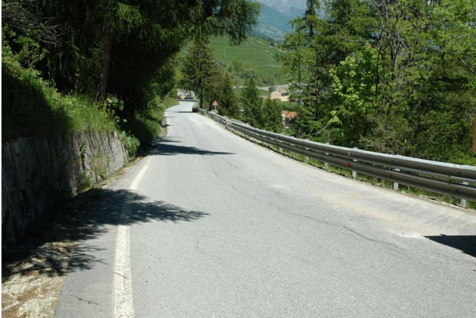
Immagine 01 - Lieve cedimento della sede stradale in seguito all'evento alluvionale del 28-30 maggio 2008. Vista da monte. Foto del 19-06-2008.
