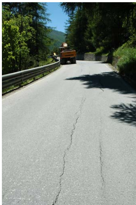
Immagine 02 - Lieve cedimento della sede stradale in seguito all'evento alluvionale del 28-30 maggio 2008. Dettaglio. Foto del 19-06-2008.
