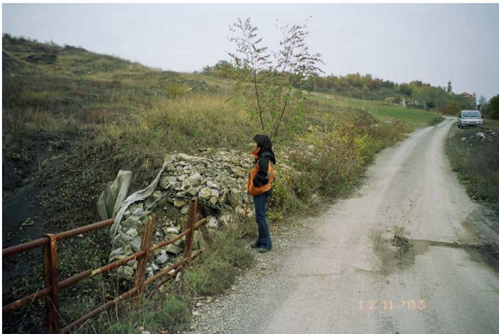
Immagine 03 - Gabbionate dislocate dal movimento franoso. Foto del 12.11.2003.
