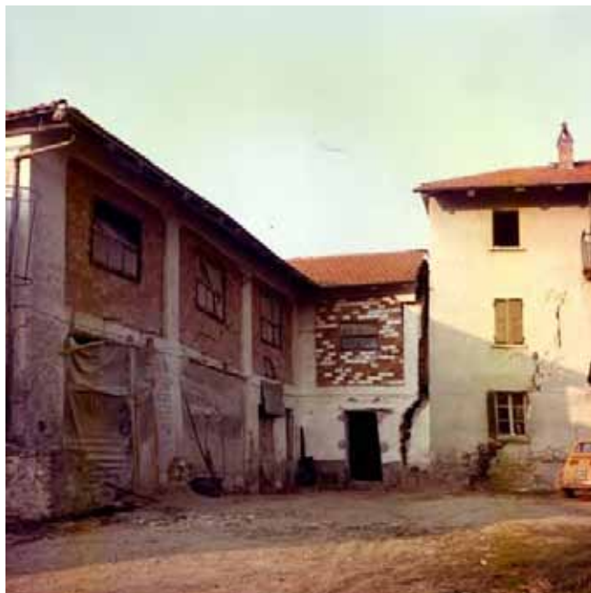
Immagine 05 - Lesioni del 1972 agli edifici di cascina Ferrera
