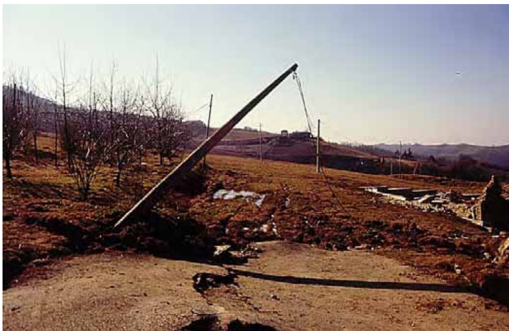
Immagine 07 - Danni a infrastrutture
