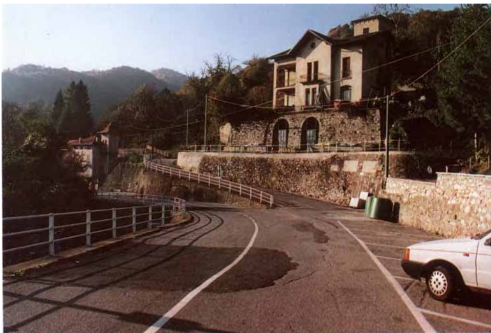
Immagine 02 - Fenomeni di attività della frana
