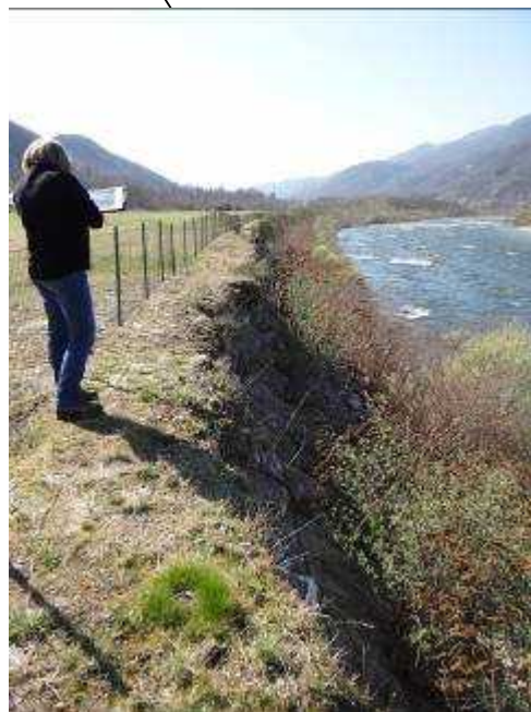
Sponda erosa in corrispondenza dell'aviocampo di Roccapietra.
