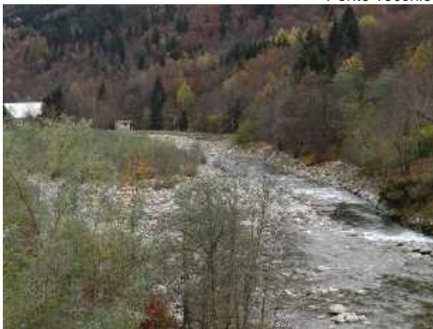
Scogliera in massi cementati a difesa della sponda idrografica destra a valle del ponte di Pila.
