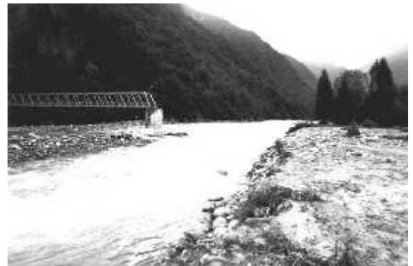
Settembre 1993: la piena del F. Sesia demolì parte del ponte in ferro ed erose la sponda sinistra, asportando le attrezzature sportive comunali. (da "Alluvioni in Valsesia")
