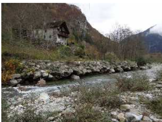
Sottoescavazione della scogliera a protezione delle baite in sponda idrografica sinistra a valle di Maggenghe.
