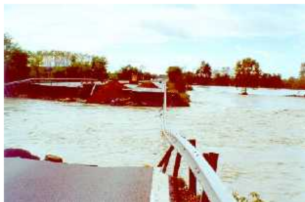
Autostrada (A4) Torino-Milano: tratto asportato dalle acque della Dora Baltea. Fotografia estratta dal Rapporto sull'Evento Alluvionale del 13-16 ottobre 2000 (Regione Piemonte)
