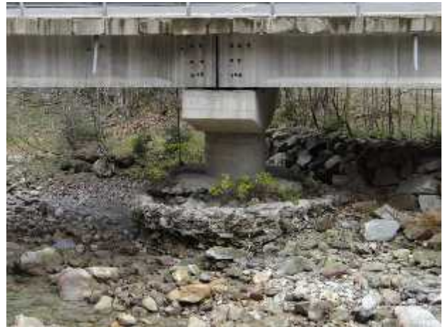
Pila del ponte di Isoello sottoescavata.
