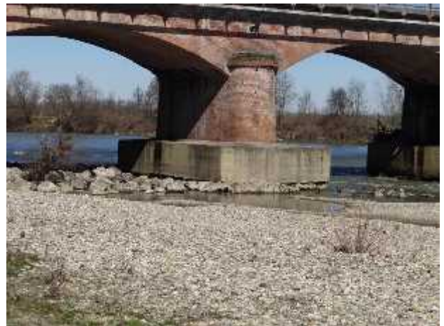
Pila del ponte sottoescavata.
