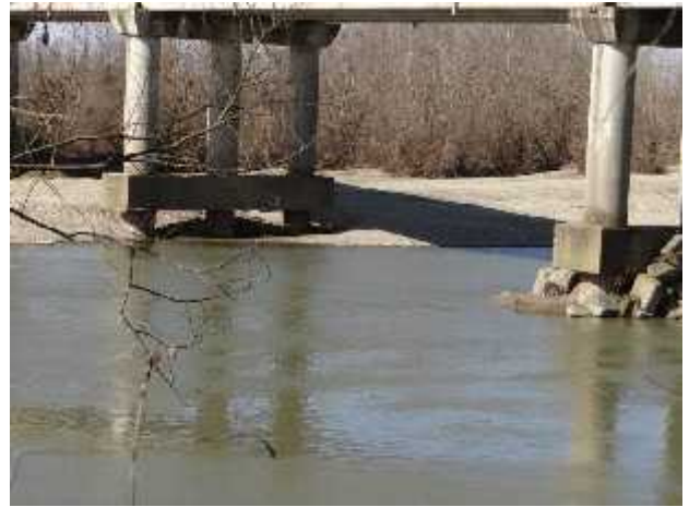
Pile del ponte della SP118 sottoescavate.
