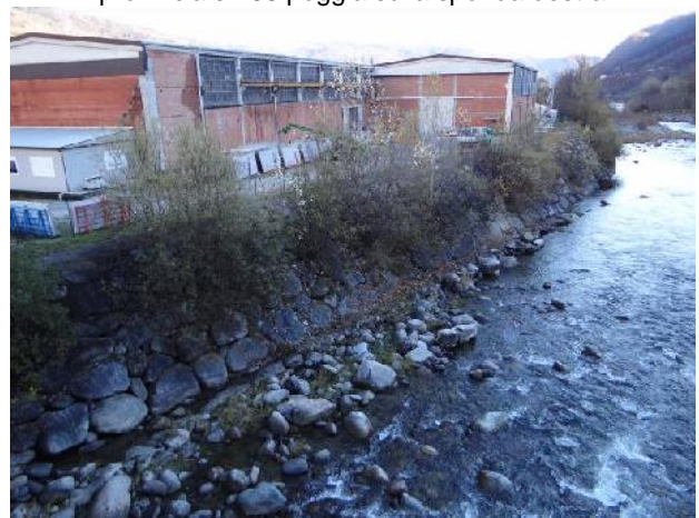
Difese di sponda al ponte per Pinasca
