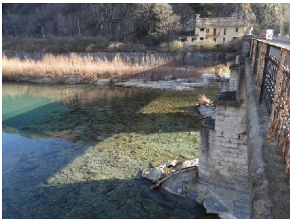
Pile parzialmente scalzate del ponte della Masone.
