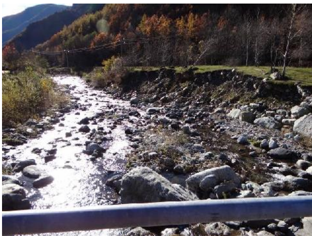
Dal ponte di Balma, vista verso valle Sponda destra in erosione
