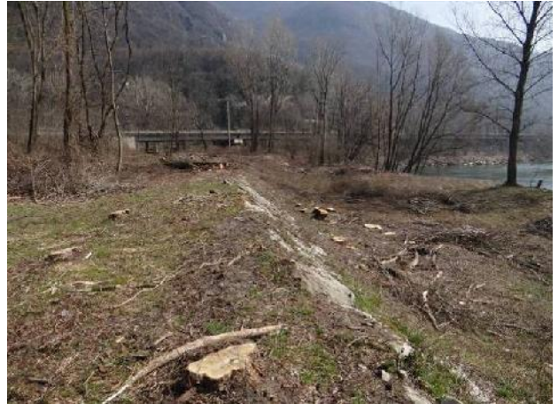
Difese di sponda costruite in fregio al corso d'acqua ora attive solo durante gli eventi di piena.
