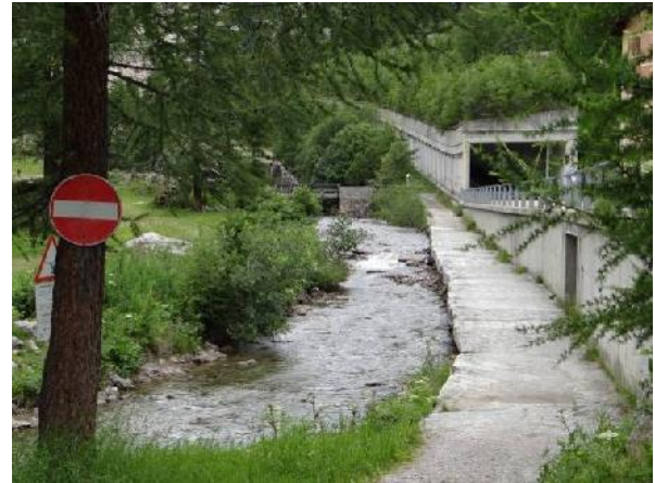
Difesa spondale con muro in cemento armato rivestito, con scogliera a protezione delle fondazioni
