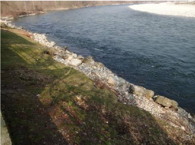
Difese spondali scalzata a monte del ponte in sponda destra.
