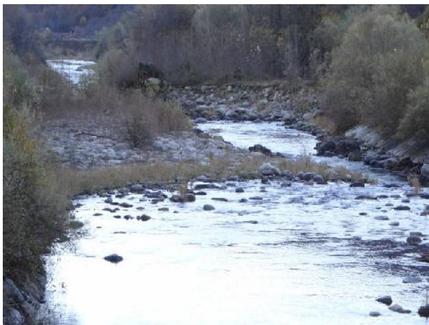
Sponde in erosione a monte di Pinasca
